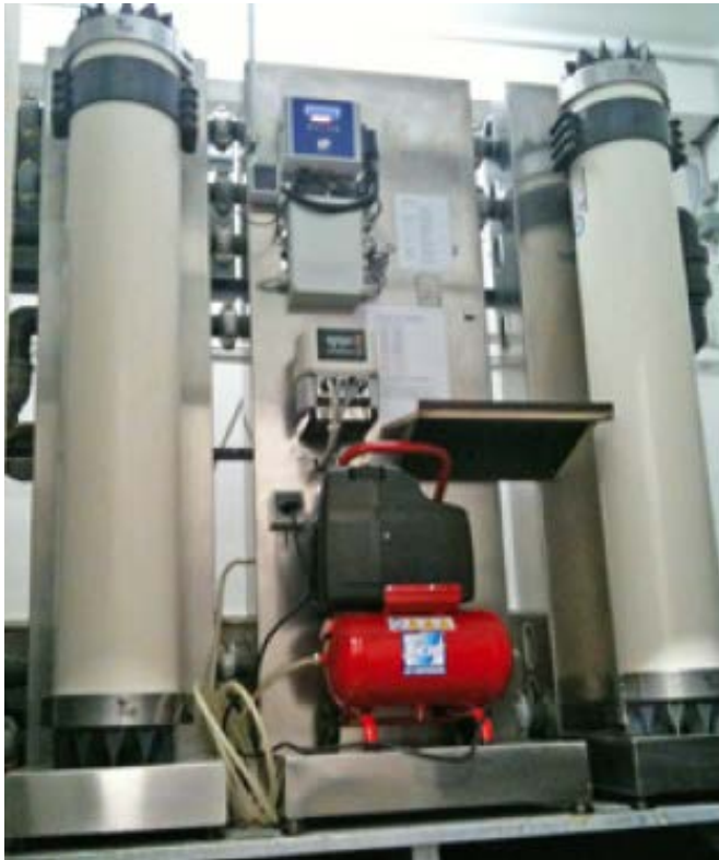
Bild 23: IN-OUT-Filtrationsanlage der Firma Seccua GmbH (Foto: Büntig, Y.)
