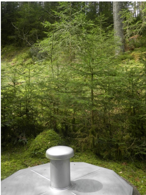
Bild 10: Quellschacht der Tannwaldquelle 1
